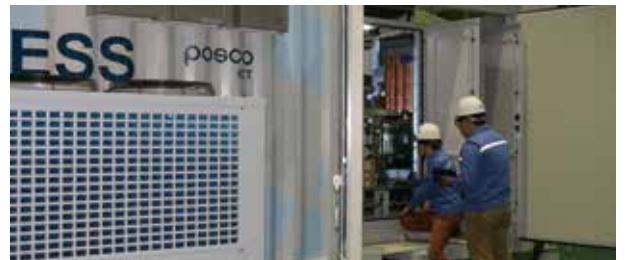
포스코ICT 포항 ESS 시험 센터(144MW)
