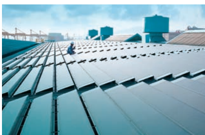
포항제철소 태양광발전 설비
