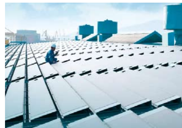
포항제철소 태양광발전 설비
